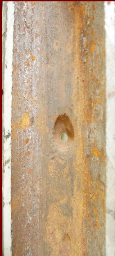
Pitting com furo
